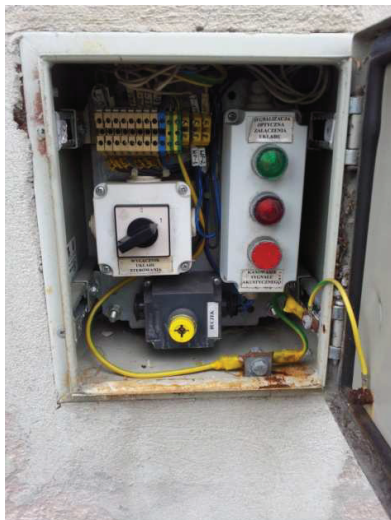
- istniejąca tabliczka sygnalizacji poziomu paliwa do demontażu
